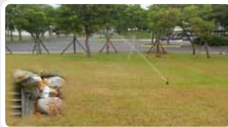
廠區自動灑水系統，調控耗水量
