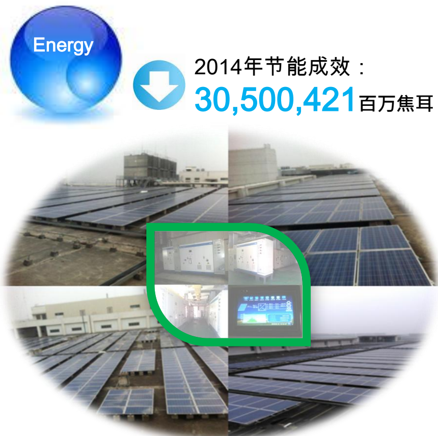
大陆厂区太阳能电站变电系统
