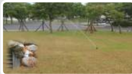
厂区自动洒水系统, 调控耗水量
